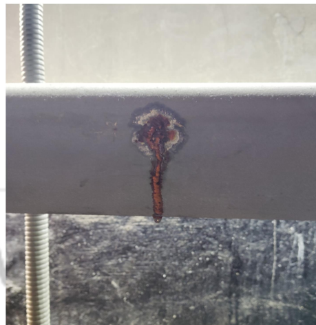
FUGA EN RECTA DE PIPING
